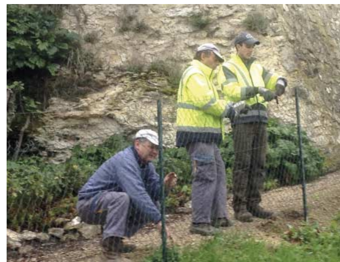
Pose d'un grillage pour sécuriser un petit sentier sur le chemin de ronde
